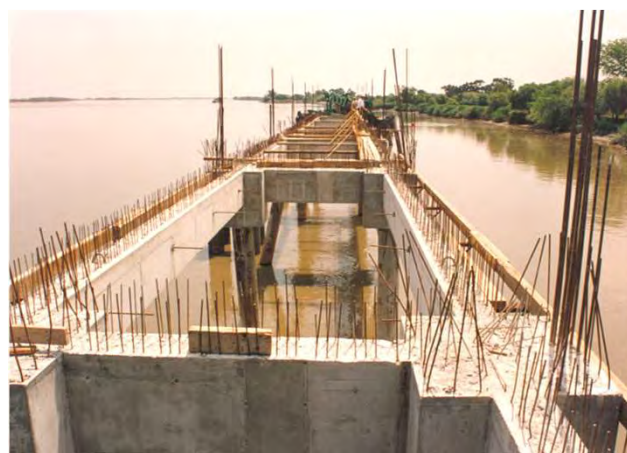
Estacas, encabeçamentos e passadiços metálicos (em cima) Cais acostável durante a fase da sua construção (em baixo) Piles and capping structures and steel structures (top view) Berthing Quay during construction phase (bottom view)
