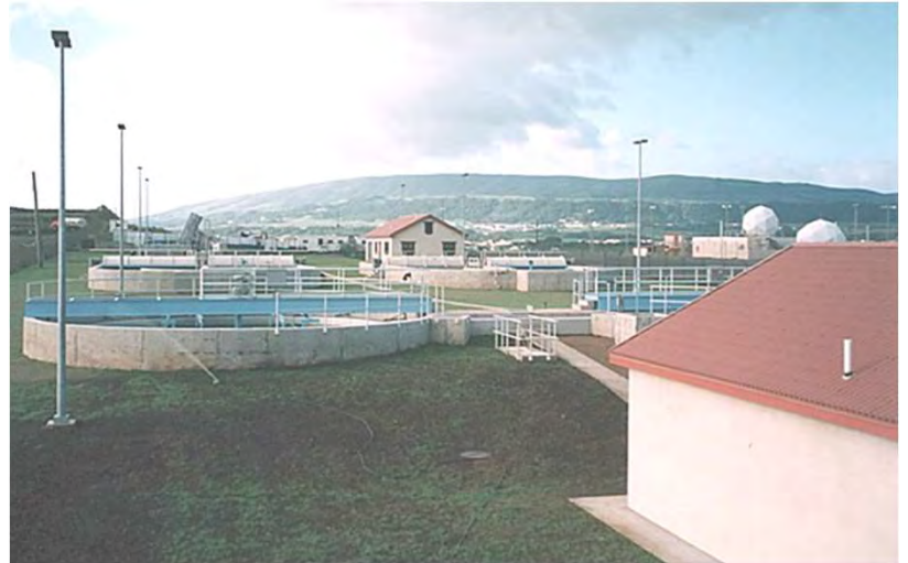
Vista geral da ETAR. Em segundo plano, os tanques de clarificação General view of the WWTP. Background: the clarifier tanks
