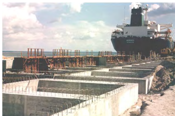
Aspecto dos trabalhos de ampliação do Cais 3 General view of the Pier 3 Extension works
