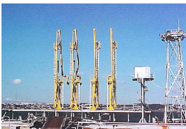
Cais de Combustíveis NATO Trafaria Braços de Carga
