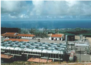
EDA - Central Geotérmica da Ribeira Grande S. Miguel - Açores
